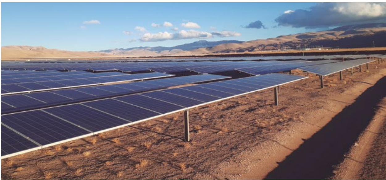
Paneles Solares en Cauchari Fuente: Manuel Arequipa
