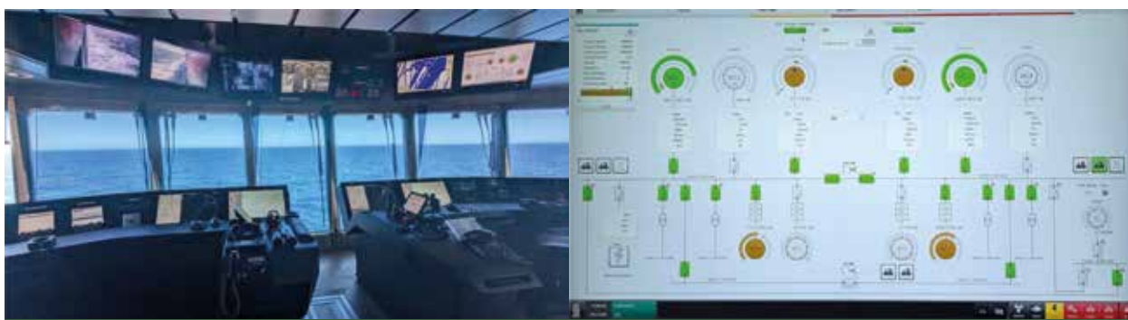
Figuras 3 y 4. Puente de mando y esquema de distribución eléctrica. Izquierda: vista general de las consolas del puente de mando. Derecha: pantalla para la visualización de la generación eléctrica y de los consumos de potencia. MG1... MG4, generadores; ESS1 y ESS2, baterías; MP1 y MP2, impulsores principales; BT1 y BT2, impulsores laterales de proa.
