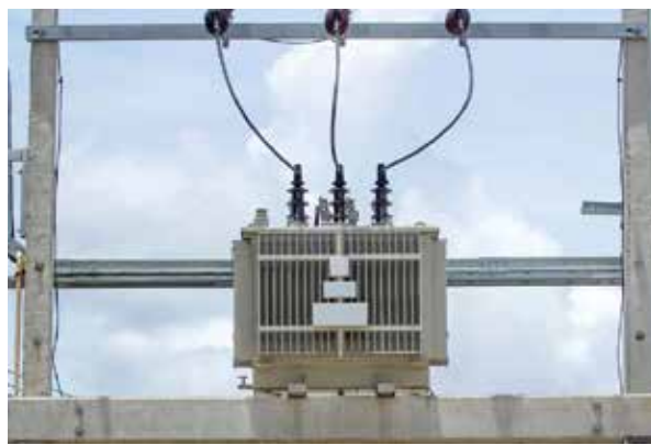
Figura 1. Un banco automático resuelve el problema de la sobredemanda de potencia estacional sin intervención manual.
